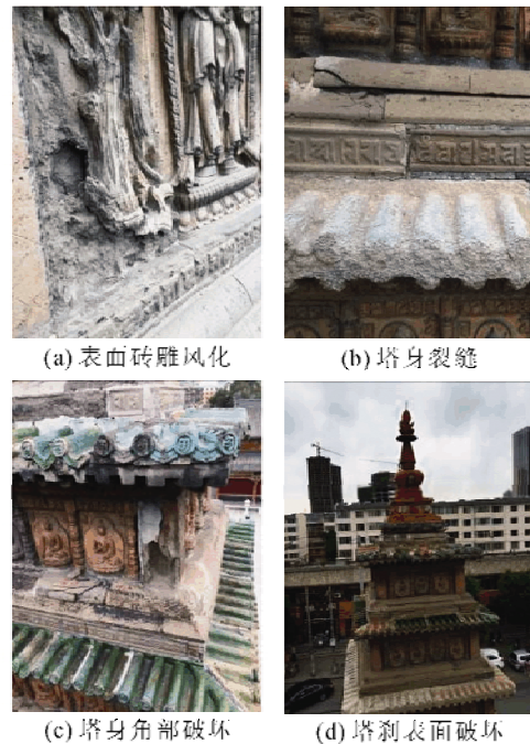
图 2 慈灯寺塔破坏状况
